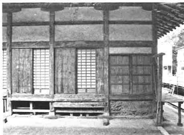
252. 本堂西面「御書院渡り廊下」痕跡 間口は一間で、庫裏渡り廊下と同型の仕口が残る
