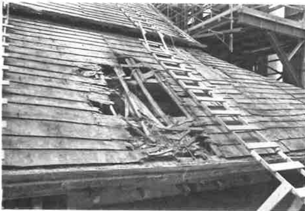
231. 屋根の破損状況 (東面) 雨水が小屋の内部まで達している。修理前は瓦上にルーフィングを貼っていた
