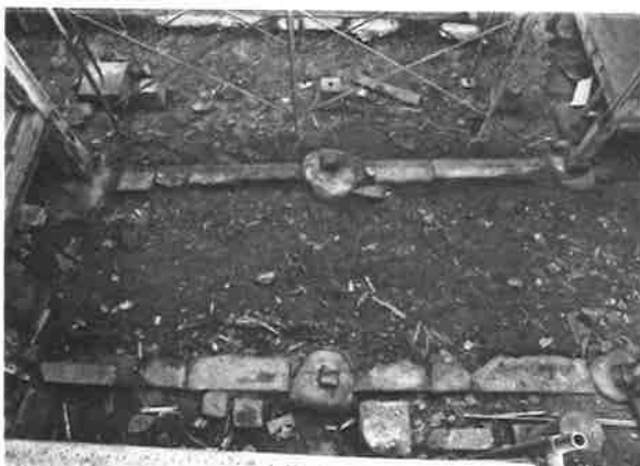
217. 書院渡り廊下 基礎の状況 東より見る 廊下の柱は本堂及び書院の柱にあわせているため、平面は台形状としている
