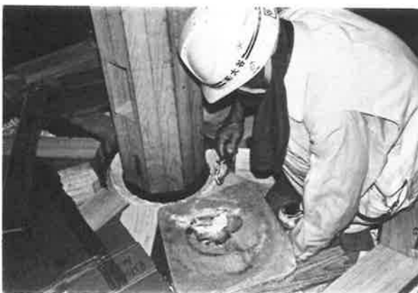
431. 心柱足元の土手 施工状況 修理前に做い、復旧した。土手内に油を充填させ、輪蔵の回転を滑らかにしたとみられる
