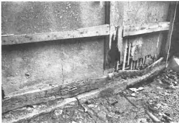
239. 南面廊下 西面の破損状況 (腰板解体後) 柱の足元が腐朽し、欠損している
