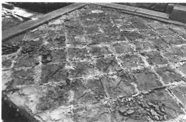
457. 四半敷瓦取外し状況 粒子の細かい土（中塗土）をぬり、その上にグリッド線を罫書きしていた
