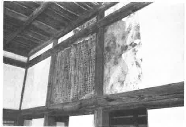
228. 南広縁の破損状況 雨漏りが内部まで達し、壁が崩落している
