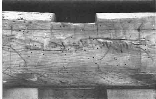
508. 受梁の墨書 (南妻 大瓶束頭繫を受ける梁) 梁間束割の中央部寸法が「三尺壹寸二分間」とあり、小屋束割りが「分」単位で計画されている
