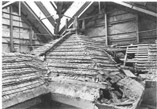
452. 本体屋根 北西隅部の破損状況 主体部北西隅部及び西面張出との取合い部分が、雨水の浸入により腐朽し、穴が開いている
