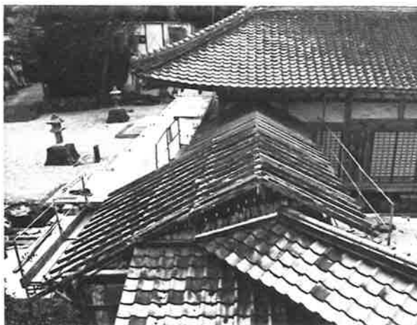
301. 北面式台玄関及び廊下 垂木の状況 式台玄関の正面側垂木は、全て廊下の桁筋で継いでいる
