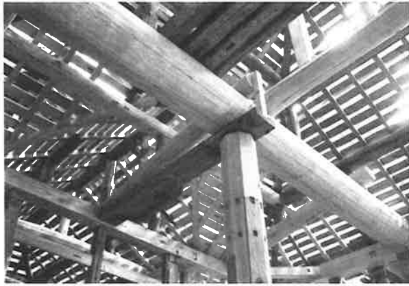
403. 輪蔵心柱の軸受取付状況 軸受は小屋内に保管されていた古材を再利用した
