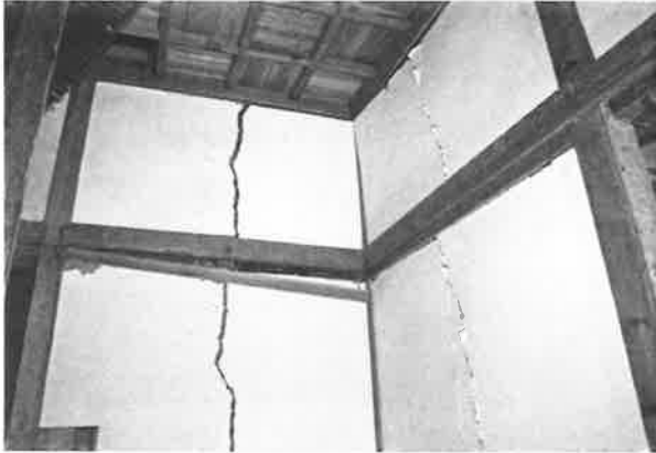
451. 内部 主体部北西隅の破損状況 隅部からの雨水及び蟻害により、壁にクラックが発生し、付鴨居が外れている
