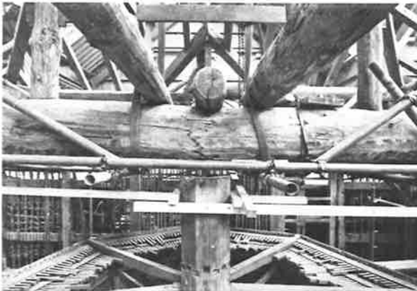
453. 梁の破損状況 中央部で折損していたが、直下の輪蔵心柱が梁を受けて建物の崩壊を免れていた
