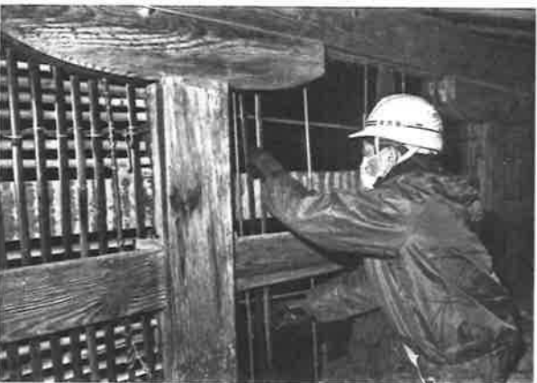
161. 外壁小舞搔状況
