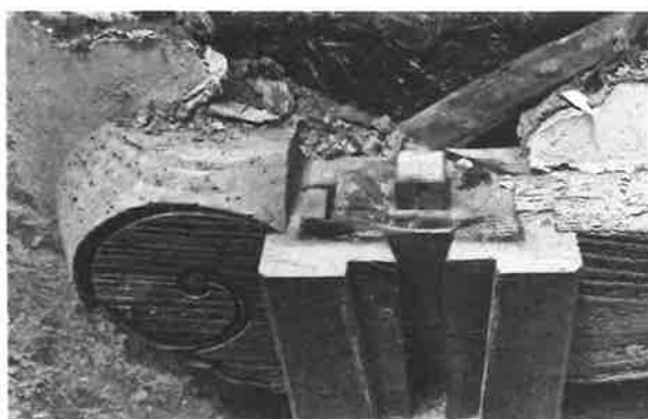
463. 向拝壁付柱向拝柱天端の大斗圧痕状況 調査の結果、九尺の柱間に対し、桁上は九尺一寸であった。圧痕をみると柱真から五分外に寄って納まっており、他に痕跡がみられないため、当初の仕事である
