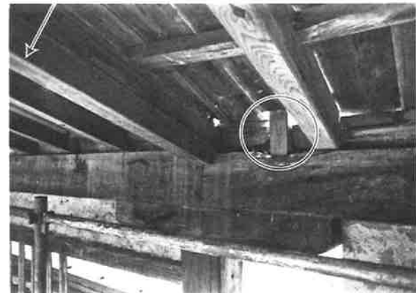
106. 要旨七 東面 側廻り見返し 現状の納まり 土居桁を受けていた力垂木を撤去したため、桁上に束を立てて土居桁を受ける
