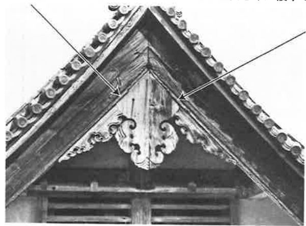
108. 要旨八 本堂修理前 南妻懸魚の状況 半分を超えて修理を受け、中央部の痕跡は残存していない
