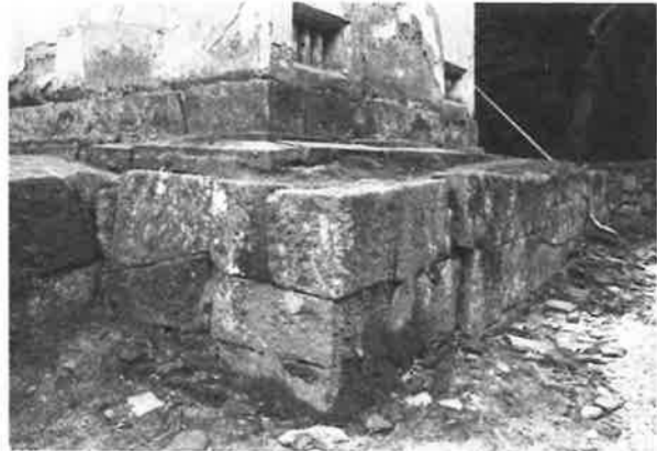
450. 北面張出し礎石及び北面石垣の破損状況 北面張出し下の造成地盤が北方向に沈下している
