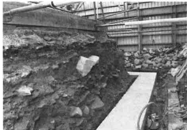
386. 北面石垣の基礎コンクリート打設状況 地盤の沈下が著しいため、厚50cmのコンクリート耐圧板を打設した
