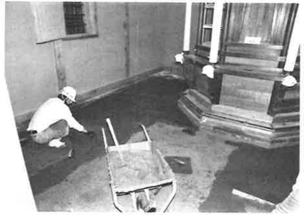
392. 四半敷瓦下の整地状況 土間叩きの後、中塗土で一旦整地した上に四半敷瓦を施工した
