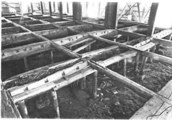
227. 「室中」と「上間」境の大引状況 蟻害により、大引内が空洞化している
