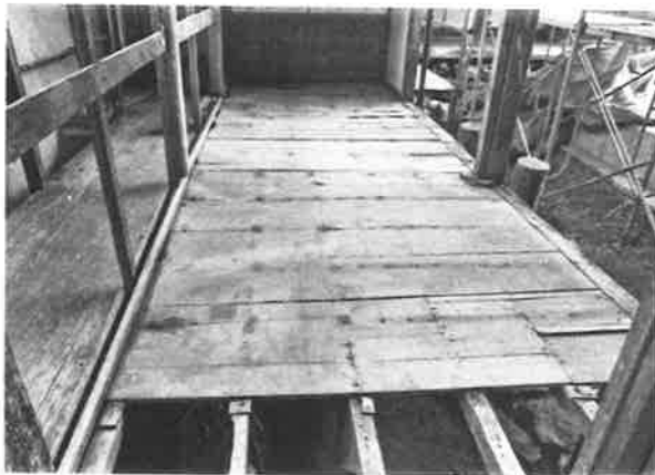
215. 書院渡り廊下 床板の状況 南より見る 現状床板の下に、旧床板が残存していた
