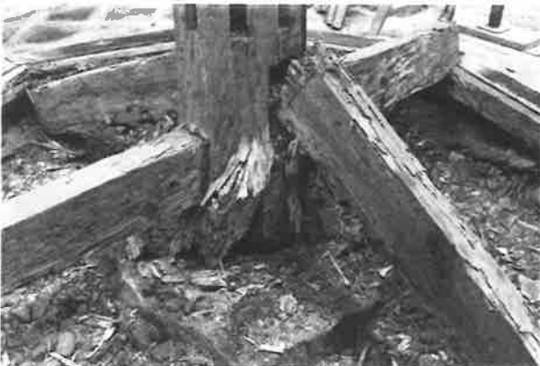
455. 輪蔵内部の状況 地下からの湿気及び蟻害により心柱が腐朽している
