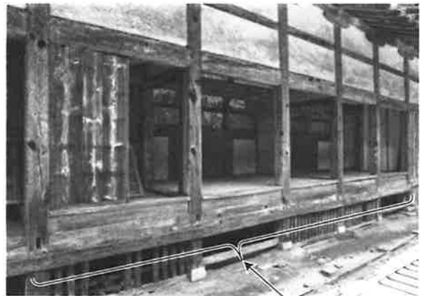
88. 要旨二 西落縁 修理前の状況 当初足固敷居が残存 当初の足固上に薄敷居と羽目板を付加し、西 落縁五間の床高を上げている
