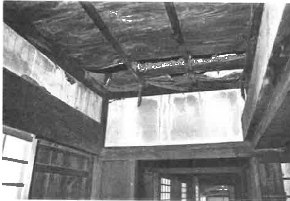
229. 「仏間」後方 天井の破損状況 雨漏りにより、小屋内の壁が破損し、天井を突き破って崩落している
