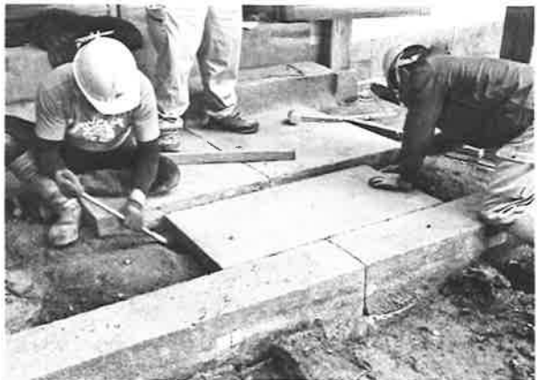
396. 向拝敷石の据直し状況 据直しにはソイルセメントを使用した
