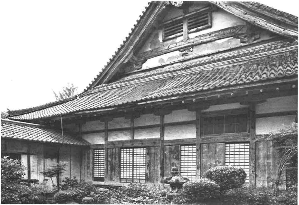
32. 修理前 北側面（北西より見る）
