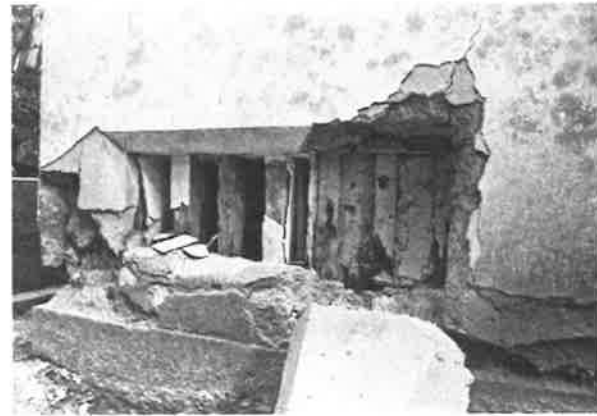
468. 西面張出しの南面換気口（修理前） 壁が崩落し、開口規模を縮小した痕跡があるが、 内部真壁の施工前に取り止めたと思われる
