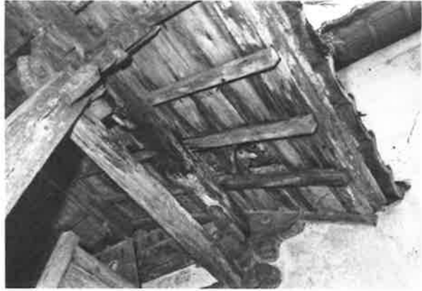
448. 向拝 軒の破損状況 雨水の侵入により、桁まで腐朽が進行している
