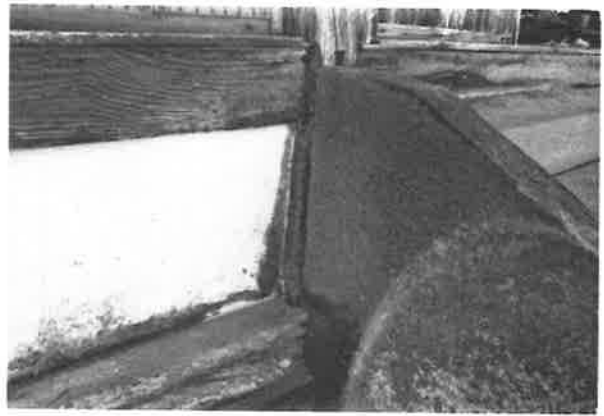
226. 正面(東)石段取合い柱の状況 雨水が柱足元に回り、腐朽している
