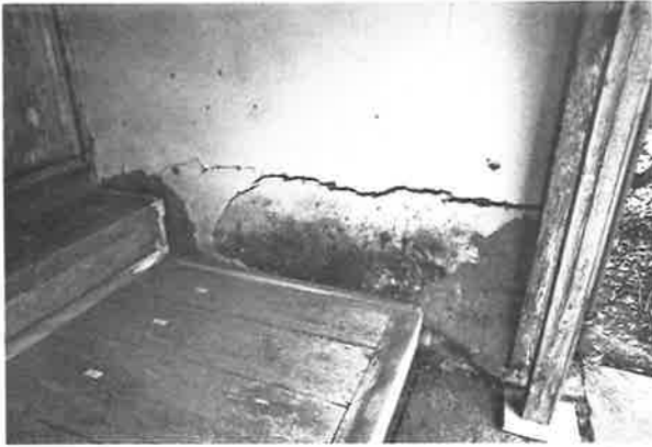
235. 北面式台玄関 北面土壁の状況 雨水により壁面の崩落やカビが発生している
