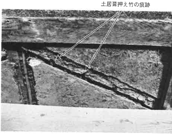
255. 同痕跡 詳細 庫裏渡り廊下同様、施工手順がわかるが、葺足は不詳であった。土居葺痕があるため、瓦葺とみられる
