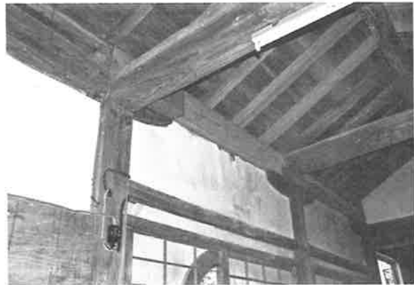
236. 北面廊下 東面見返しの状況 雨漏りにより、壁や木部が汚損している
