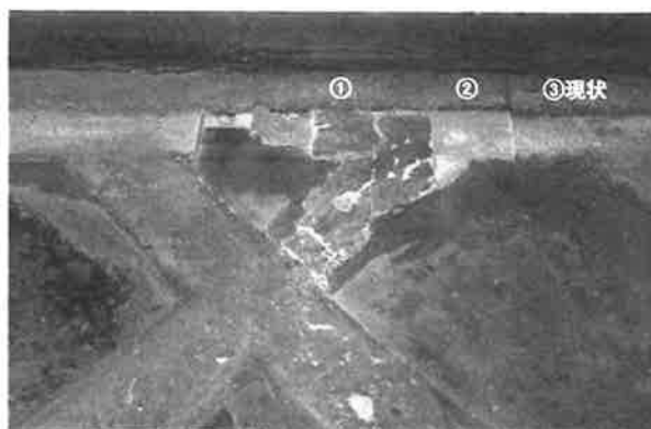
456. 四半敷目地漆喰 西面張出し 旧仕上げ面に漆喰を塗り重ねて補修をしており、主体部及び西面張出しは二回の補修が認められる。一方、北面張出しは補修痕はなく、当初とみられる
