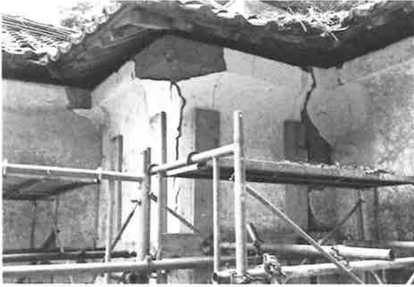
449. 主体部北西隅の破損状況 壁が崩落寸前で、仮設材で押さえている
