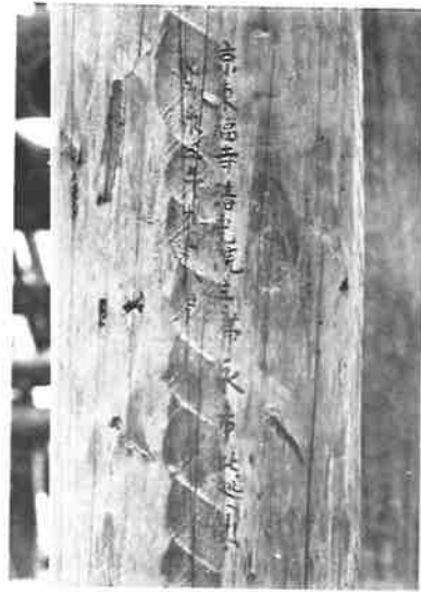
514. 小屋束墨書 (落書) 小屋組中央の束にあり、屋根修理中に書かれたとみられる
