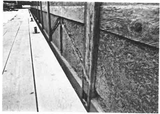
254. 本堂西面「御書院渡り廊下」壁解体時の状況 屋根の取付き痕跡が残存する
