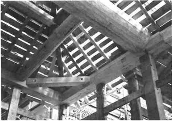
401. 構造補強状況 主体部隅に火打梁を挿入し、取付仕口のない各張出しの桁・土台を金物で繋ぐ
