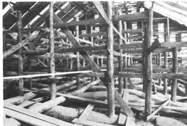
263. 小屋組の状況（解体番付「る」通りを見る） 妻の化粧材などを受ける繋ぎ梁は、妻から三通り りまで入るが、それより内側の小屋束は、割付 を変えて数を減らしている
