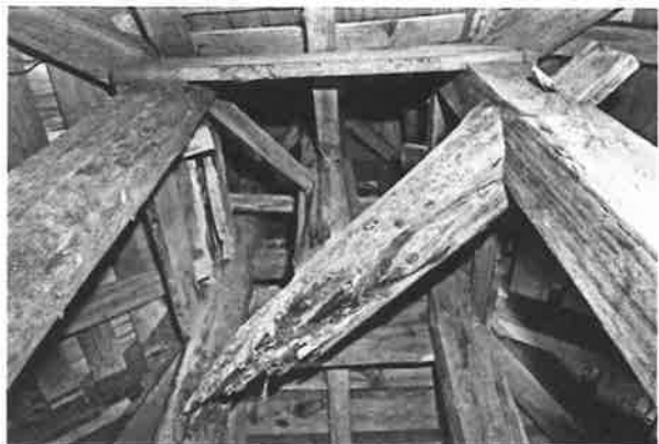
454. 越屋根内部の状況 受梁が腐朽し、欠損している
