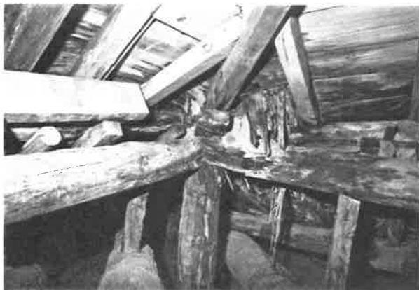
233. 野隅木の破損状況 (東北部) 鍔葺部分から雨水が浸入し、蟻害を伴って破損している
