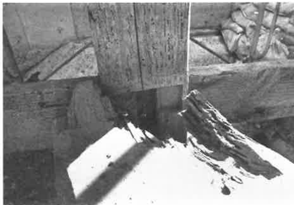
241. 南面廊下 東面 大引の破損状況 雨水、蟻害により木口が腐朽し、大引が空洞化している
