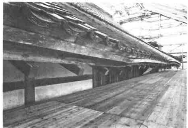
230. 軒の破損状況 (東面) 雨水による軒廻り腐朽のほか、周辺樹木の枝が接触していたことにより、軒の破損が著しい
