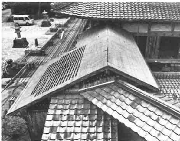
299. 北面式台玄関及び廊下 野地板の状況
