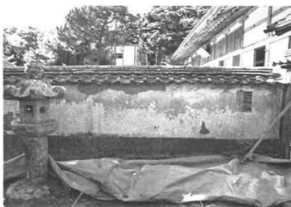
220. 土塀 撤去前の状況 本堂素屋根に支障となる土塀を一旦撤去した (石積を存置して養生を行う)
