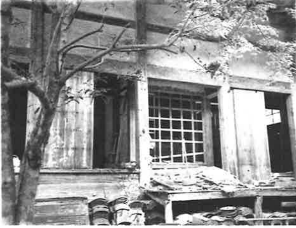
93. 要旨三 平成四年トコ廻り撤去時の写真 (株式会社中原工務所撮影) トコ内部は下地骨が組み、貼付壁としている
