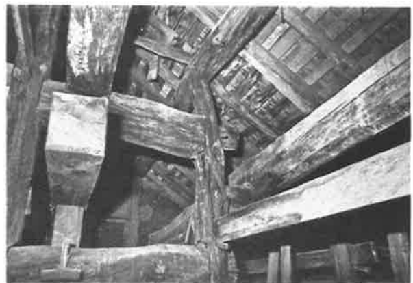
232. 小屋内部の破損状況 (西面) 雨水により小屋束が腐朽し、折れている
