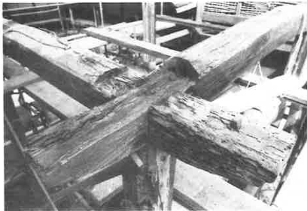
237. 北面式台玄関及び廊下 入隅柱上部の状況 雨水の浸入により梁の端部が腐朽している (肘木の造出し)
