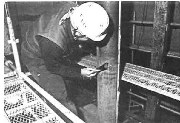
174. 漆塗 錆付状況
