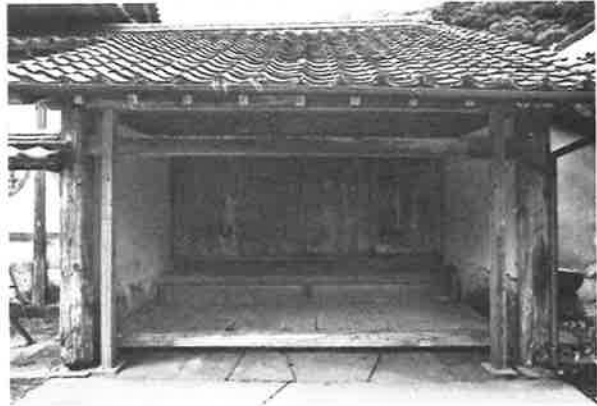
234. 北面式台玄関 東面の状況 柱が腐朽し、添柱で補強している
