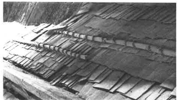
274. 当初土居葺残存状況 破風下に当初土居葺がわずかに残存しており、他の箇所より葺足が細かい。木端材の幅は狭いが、長さは約39cmあり、中古のものに比べて9cm長い
