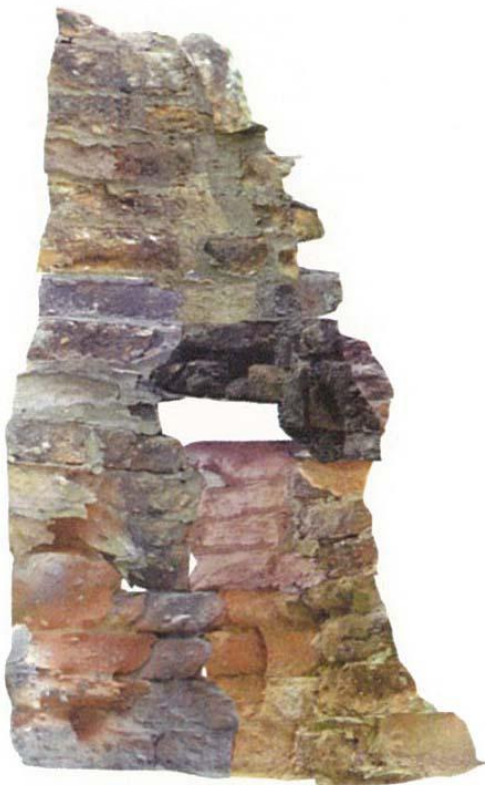
写真 3-6 西側煙道東面内側 煉瓦積部目地損傷狀況
