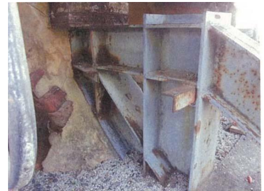
写真 3-11 鉄骨補強材腐食状況
