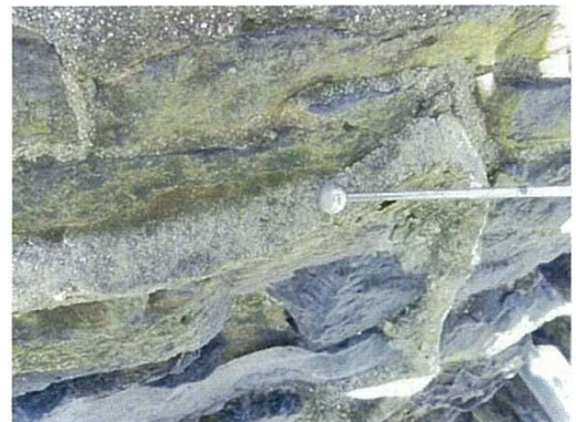
写真 3-13 漆喰補強モルタルの浮き
