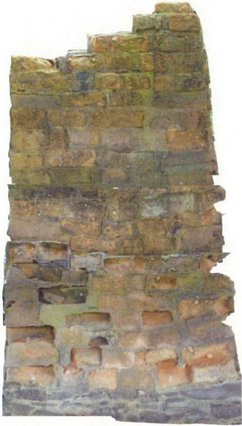
写真 3-4 西側煙道西面 煉瓦積部目地損傷狀況
