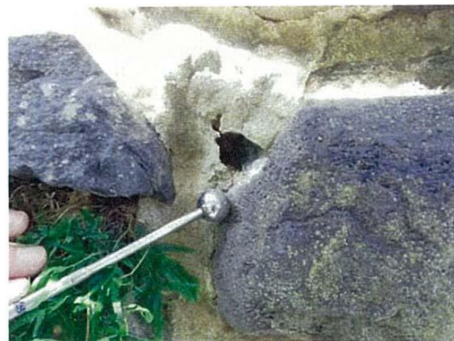
写真 3-14 石積部煙道南面東側 目地の空隙
