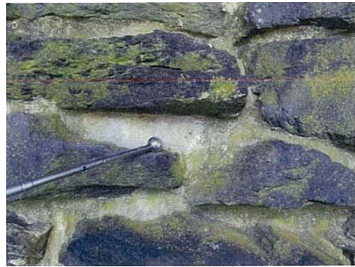
写真 3-19 滲水・塩類析出跡 煙道東面
