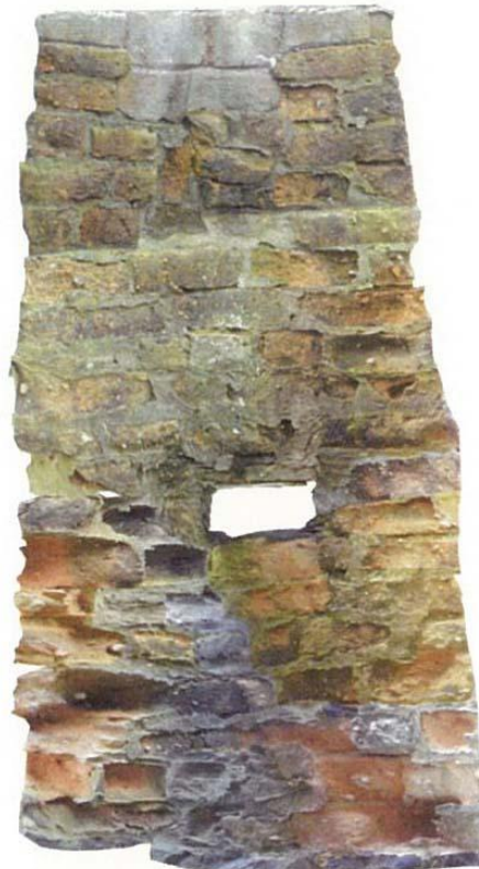
写真 3-7 東側煙道西面内側 煉瓦積部目地損傷狀況
