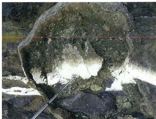
写真 3-12 残存する当初漆喰 全面浮いた状態
