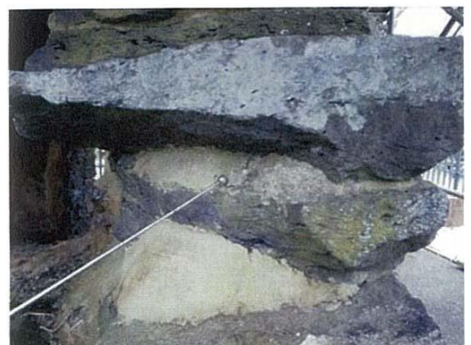
写真 3-15 石積部煙道北面西側 目地の浮き
