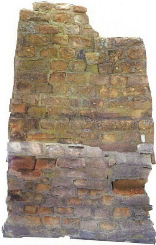
写真 3-5 西側煙道南面 煉瓦積部目地損傷狀況
