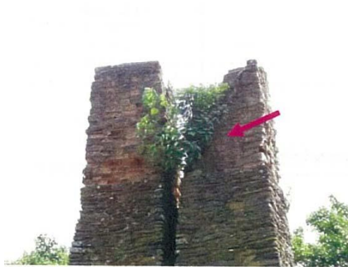
写真 3-16 煙道上部に生育した樹木
