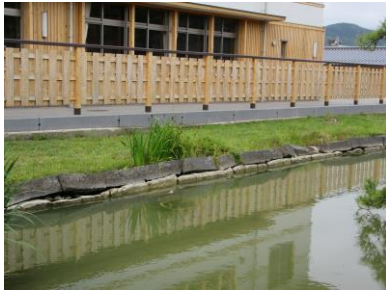
石積み護岸のき損箇所
