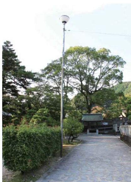
写真㉑ 照明設備
