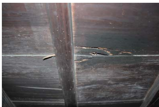
修理計画箇所その1 (天井板の破損)
