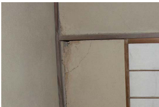
修理計画箇所その 1 (壁の亀裂、破損)
