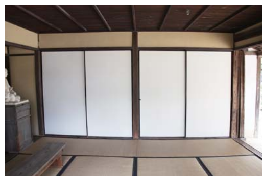
修理計画箇所その4 (襖、畳の劣化)
