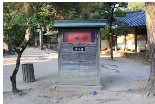
写真⑦ 消火栓
