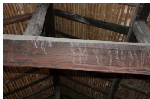
修理計画箇所その 4 (雨漏りの痕跡)
