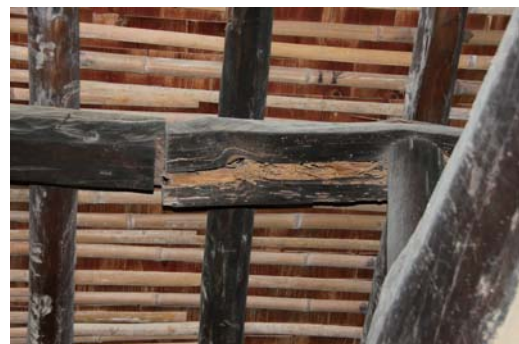
修理計画箇所その 2 (母屋の腐朽)
