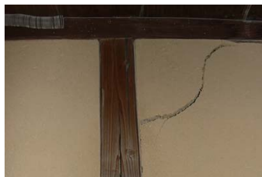
修理計画箇所その2 (壁の亀裂)
