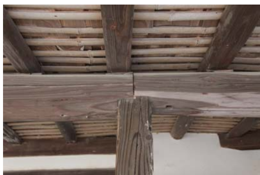
修理計画箇所その3 (継ぎ手の開き)
