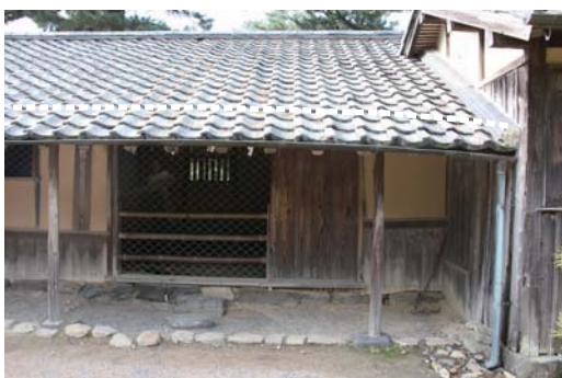
修理計画箇所その 3 (軒先の傾き)
