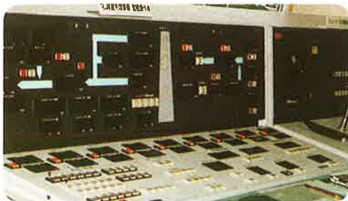
ダムかん理事む所のテレメーター室
