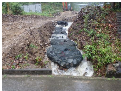
■出水状況（着手前）
